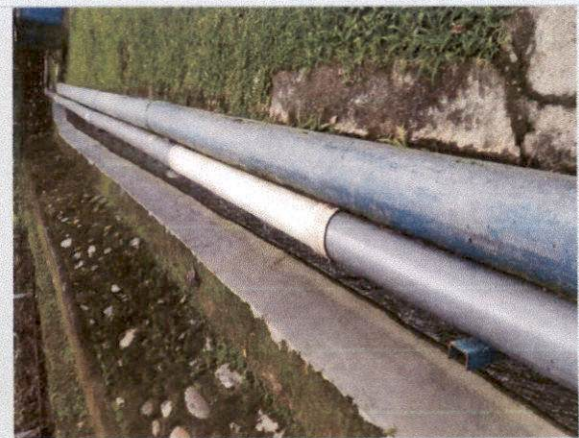
Pipa air baku di alirkan secara gravitasi dari intake sungai Bukae.
