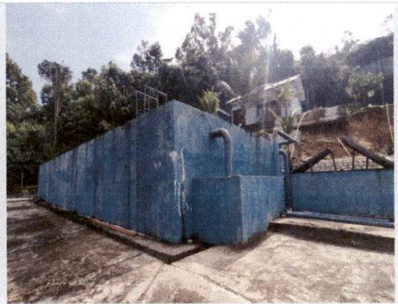
Bak Saringan Pasir Lambat yang sudah tidak difungsikan
