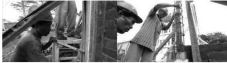
Gambar II.416 Pemasangan Beton Dengan Memukul-mukul Cetakan/ Bekisting dan Campuran Beton Dirojak Menggunakan Besi atau Bambu
