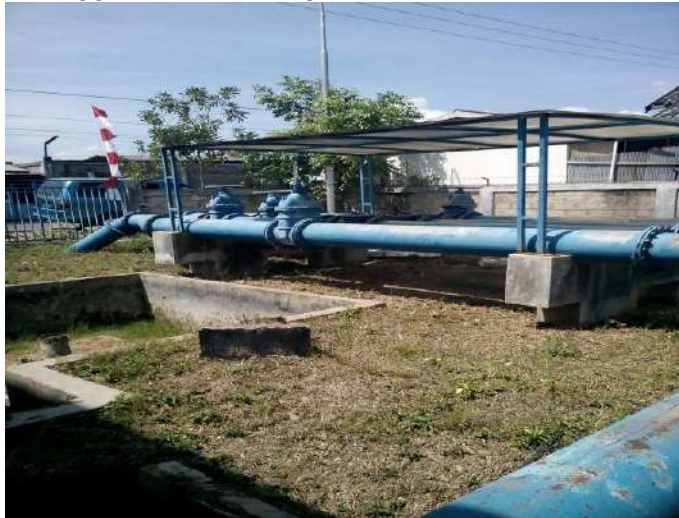
Gambar 3.27 Pipa Distribusi (transmisi) Cabang I Landasan Ulin
