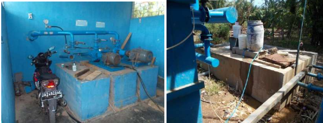
Gambar 3.30 Pompa distribusi dan Reservoir di IPA Cabang III Astambul
