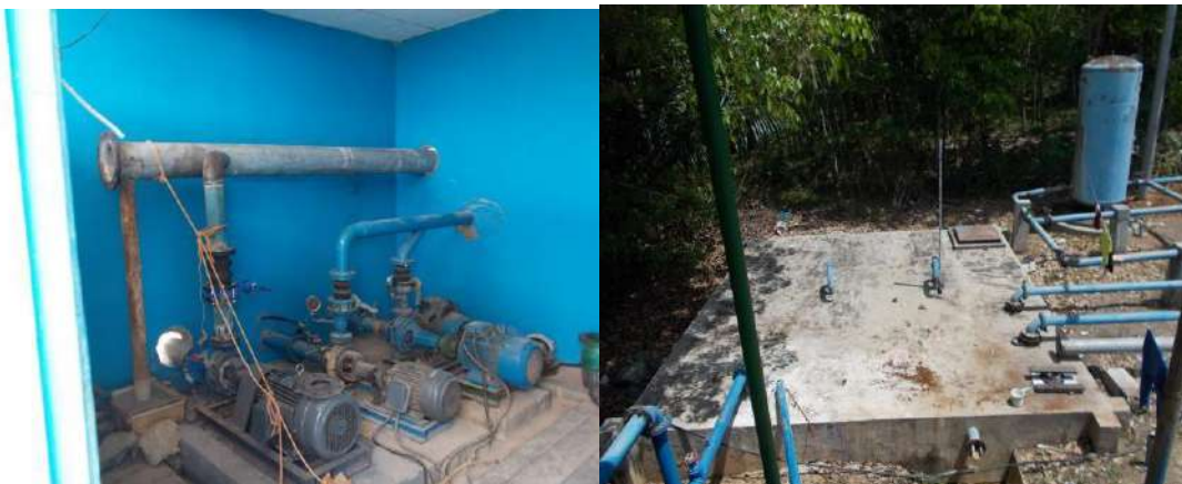
Gambar 3.29 Pompa distribusi dan Reservoir di IPA Cabang III Pengaron
