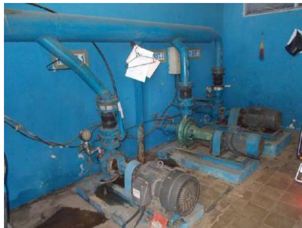
Gambar 3.32 Pompa distribusi pada Unit II IKK Simpang Empat
