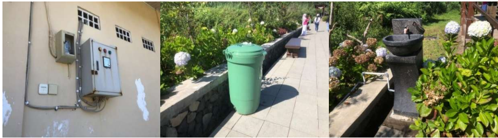
(a) Infrastruktur Energi Listrik
