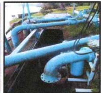
Gambar 3.8 Sumur Pengumpul dan pompa pada unit intake 1
