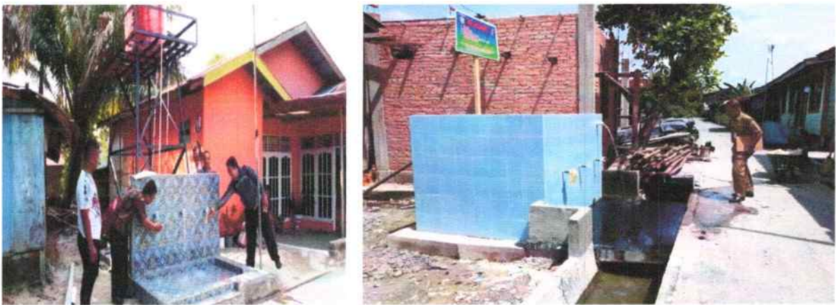
Gambar 3.36 Pembangunan Sumur Bor Oleh Dinas Perkim Kota Pekanbaru Sumur Bor yang telah dibangun sampai 2020 sebanyak 173 sumur di bangun di berbagai kecamatan yaitu :
